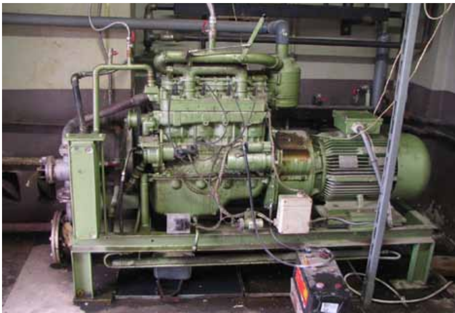
Fot. 2. Układ kogeneracyjny biogazowni w Studzionce
